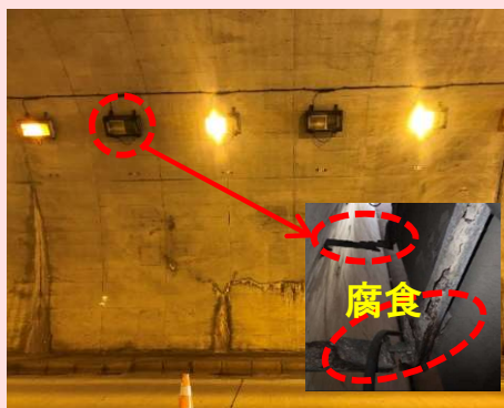
▲附属物取付部の腐食
