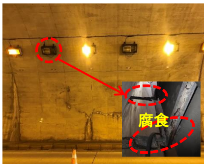
▲ 附属物取付部の腐食
