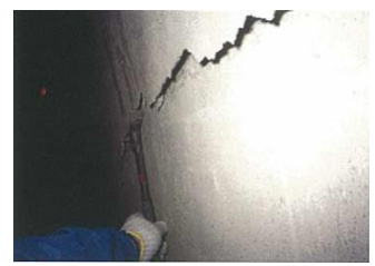
▲ 段差を伴うひび割れ
