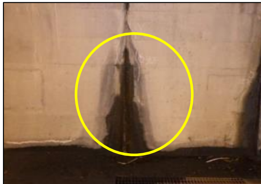
【覆工からの漏水】
