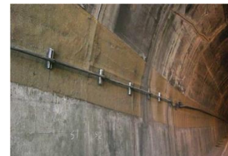
▲ 繊維シートの接着(劣化により落下が懸念)
