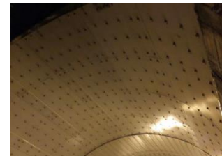
▲ アンカーボルトにより固定された鋼板(ボルトの取付異常により落下が懸念)
