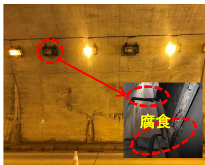
▲ 附属物取付部の腐食
