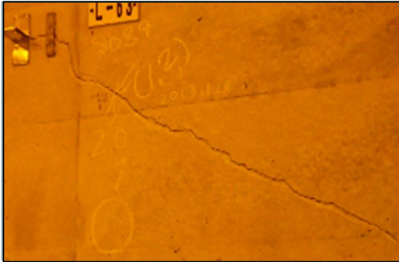
【覆工のひび割れ】
