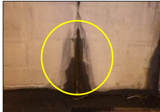
【覆工からの漏水】
