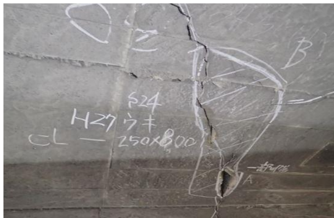
【覆工のうき・はく離】
