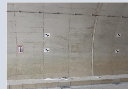
R3実施状況(設置例)
