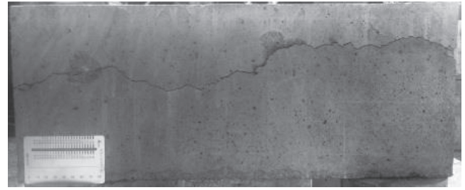
写真一 3 水平ひび割れを有する試験体
