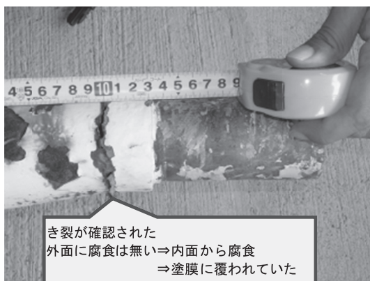
図一四 支柱先端の灯具取付け部のき裂
