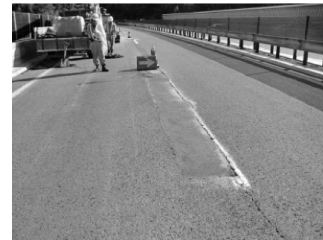
写真—2 上面増厚床版（施工目地部）の再損傷
