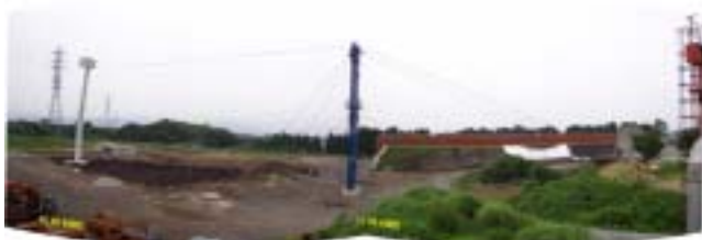
写真 - 2 試験設備全景
