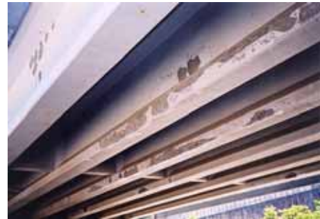
写真 1 コンクリート橋の塩害
