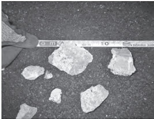
写真—1 覆工コンクリートのはく落片の一例 3)
